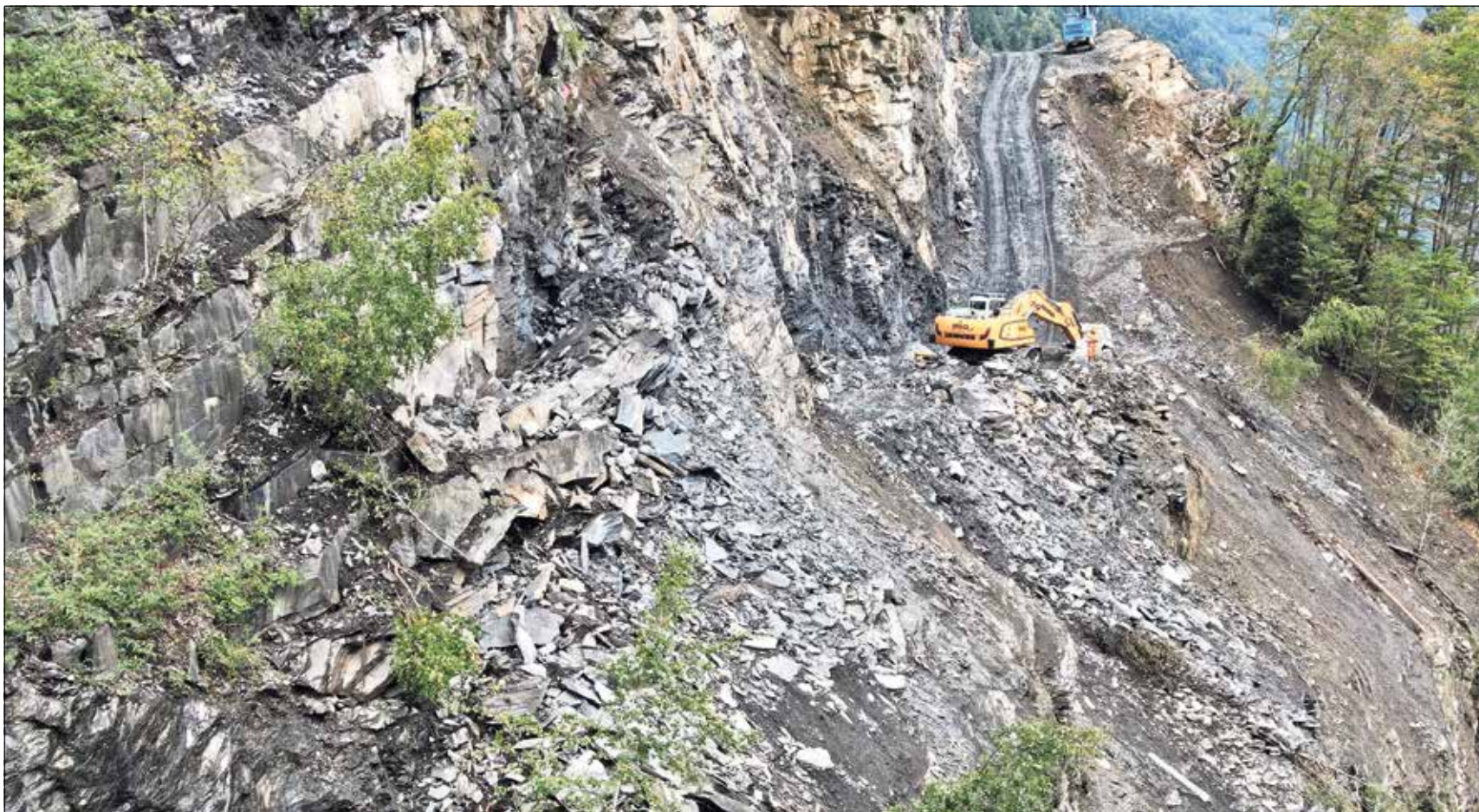
Erstellung einer Abtreppung im Fels, einer sogenannten Berme. Blick von der Deponie Eielen Richtung Steinbruch Gasperini.
